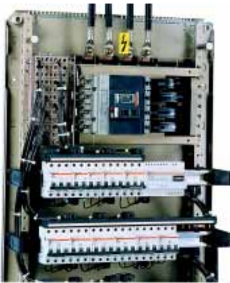
NS 250 en montage horizontal alimenté par liaison préfabriquée 07205. Répartiteur Polybloc 07102.
