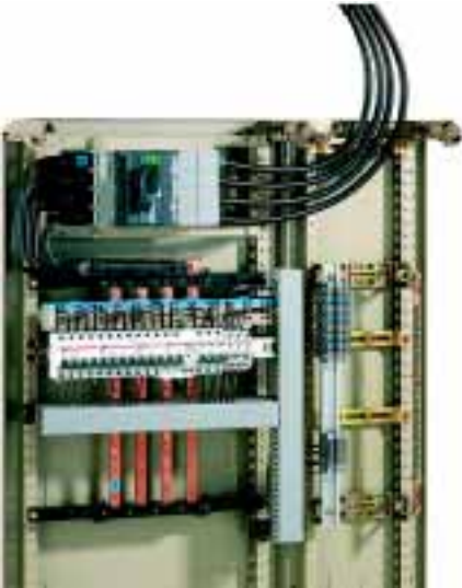
INS 400 horizontal raccordé sur jeu de barres par liaison préfabriquée 07034. Disjoncteurs Multi 9 alimentés par Multiclip 07004. Support de bornes (07548) dans la gaine de 300.
